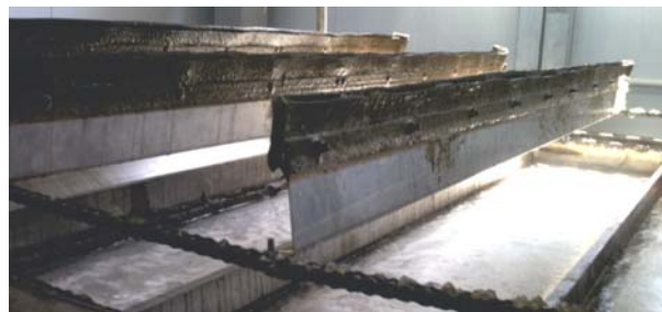
Рис. 4. Общий вид флотатора Fig. 4. General view of the skimmer
