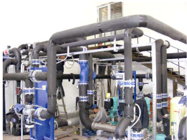
Рис. 2. Оборудование геотермального центрального теплового пункта в пос. Розовом, Лабинский район Краснодарского края Fig. 2. Equipment of geothermal central heat point in the Rozoviy settlement, Labinsk area, Krasnodar region
