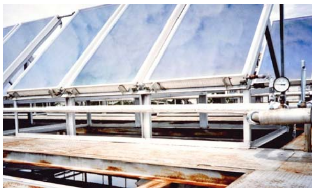
Рис. 5. Гелиоустановка горячего водоснабжения СГУ Fig. 5. Solar power plant for hot water supply SSU
